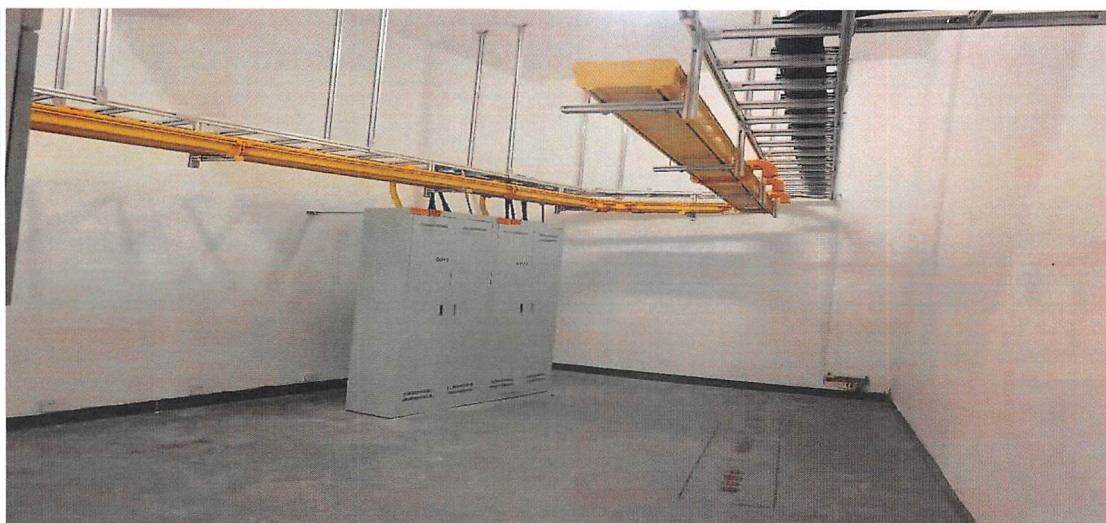
附图 11：电信间桥架、尾纤槽、机柜建设场景图
